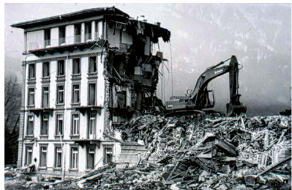
Quellenhof in Bad Ragaz: Abbruch und Neubau führen nach den Kriterien der Substanzerhaltung zum Totalverlust.
